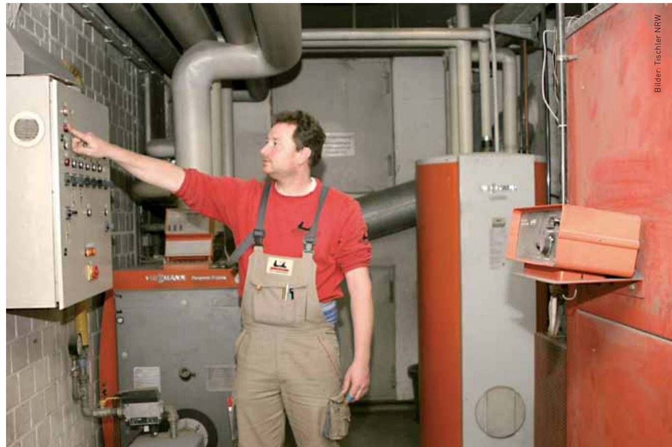
Alles in Ordnung: Werkstattleiter Frank Schneider ist für die Wartung der Holzfeuerungsanlage zuständig.
